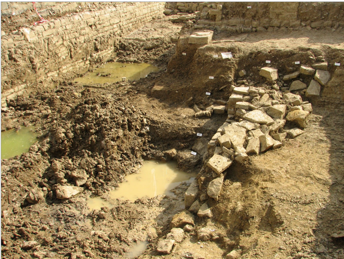
Fig. 6. Cantiere retrostante il palazzo della Curia, scavi 2008, specchio d'acqua interrato fra la sponda ed il muro laterale della strada litoranea.
